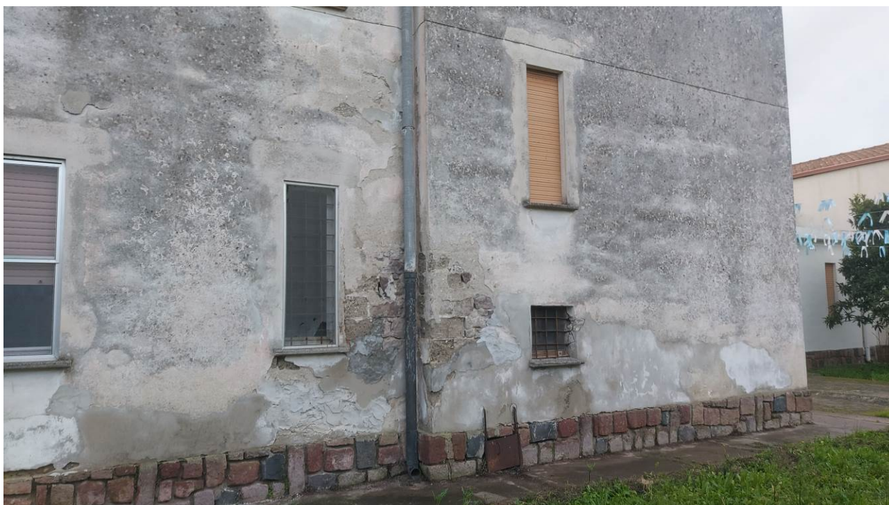
L'intonaco degradato nel prospetto settentrionale
