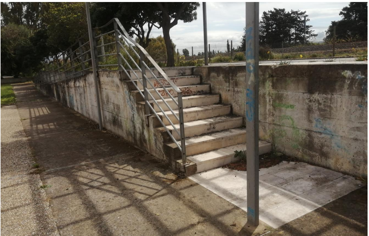
Fig. 13. PIAZZA VICO I PAOLO I - DETTAGLIO SCALINATA E RAMPA DI INGRESSO IN BIANCONE DI OROSEI CON EVIDENTE INVECCHIAMENTO DELLE TINTEGGIATURE DEGLI ELEMENTI MURARI
