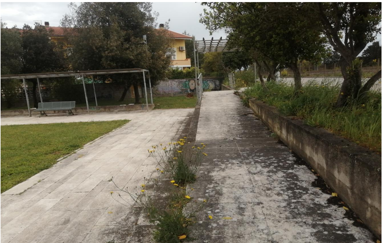
Fig. 11. PIAZZA VIA PAOLO I - RAMPA DI INGRESSO IN BIANCONCINO DI OROSEI CON EVIDENTE INVECCHIAMENTO DELLE TINTEGGIATURE DEGLI ELEMENTI MURARI
