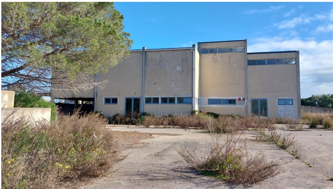
Foto stato di fatto – Edificio Ex Macello - Presenza di folta vegetazione anche sulle aree pavimentate
