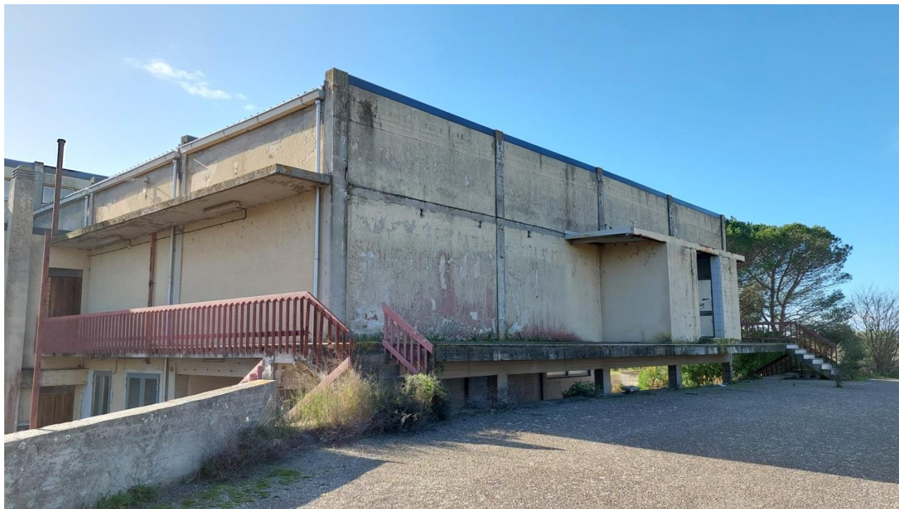
Foto stato di fatto – Edificio Ex Macello (B e B') - Degradato intonaco e ringhiere
