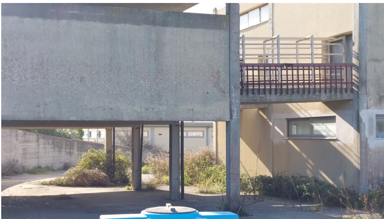
Foto stato di fatto – Edificio Ex Macello (B e B') - Presenza di vegetazione anche sulle aree pavimentate – Degrado intonaco
