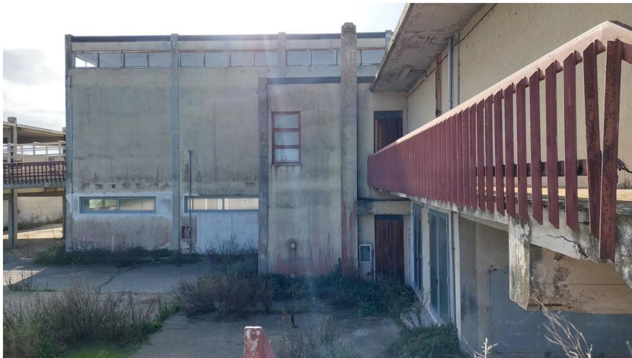
Foto stato di fatto – Edificio Ex Macello (B e B') - Degrado intonaco, ringhiere ed elementi strutturali (ferri in vista)
