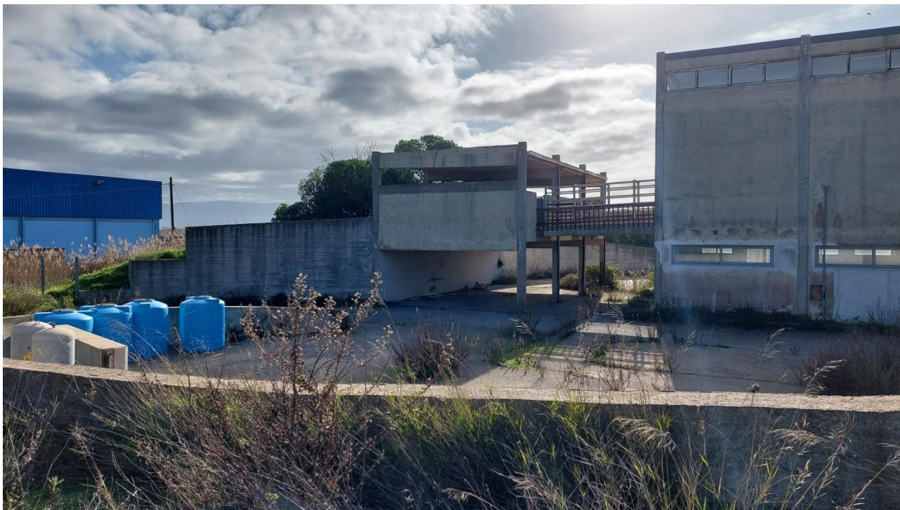
Foto stato di fatto – Edificio Ex Macello (B e B') - Degrado intonaco
