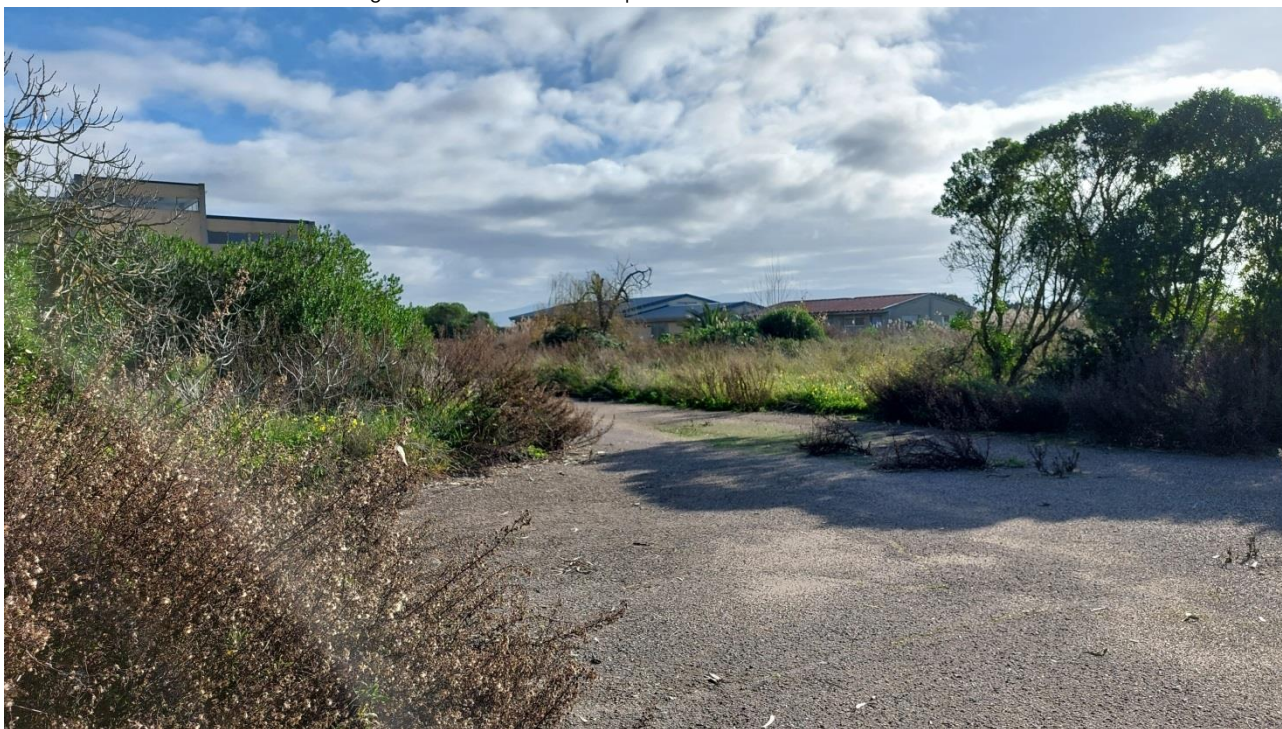
Foto stato di fatto – Presenza di folta vegetazione anche sulle aree pavimentate
