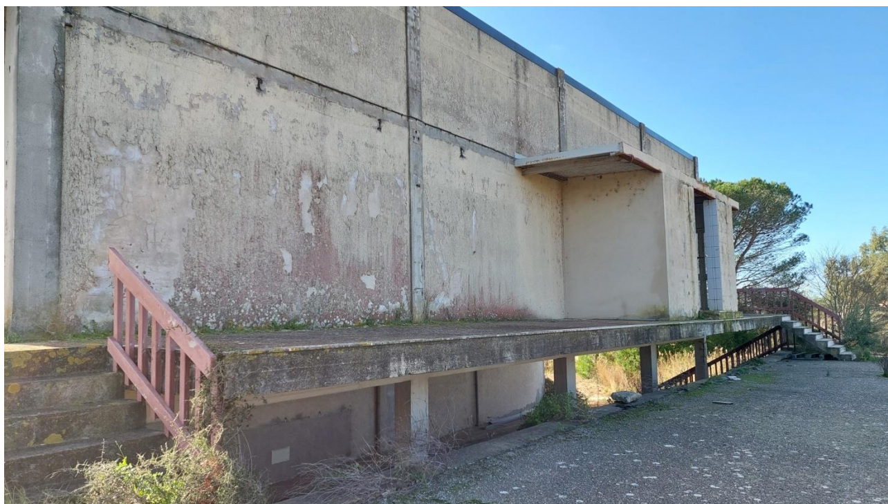
Foto stato di fatto – Edificio Ex Macello (B e B') - Degrado intonaco e ringhiere
