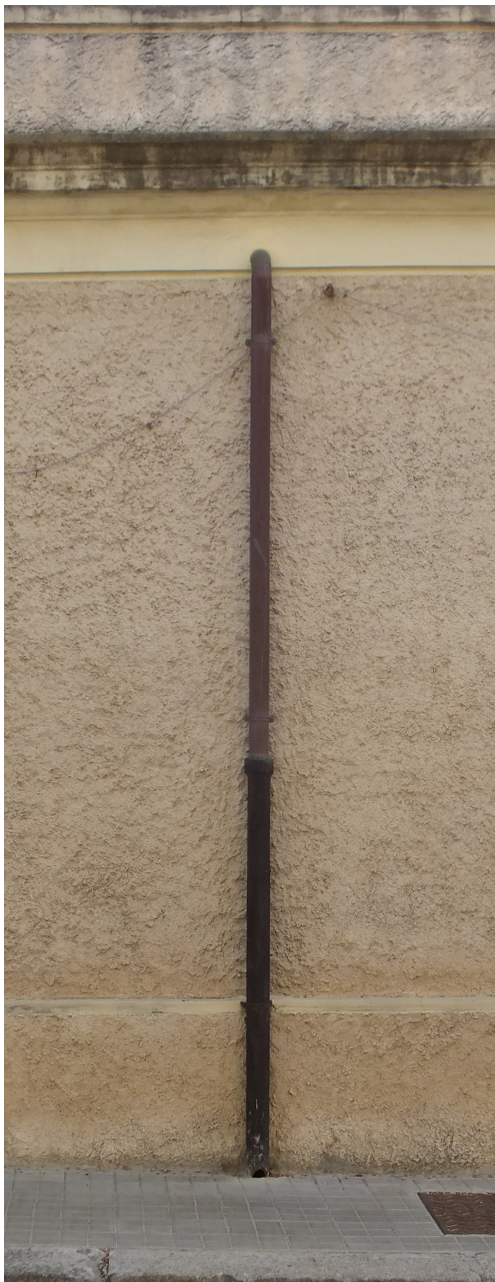
Pluviale con connessione diretta al canale di gronda
