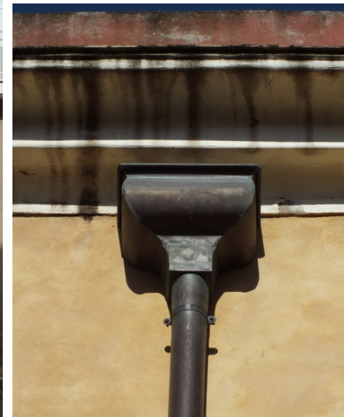
Via Crispi, particolare imbuto
